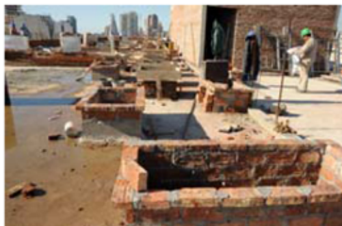
Perforaciones en las azoteas del Edificio Rojo - Ministerio.
