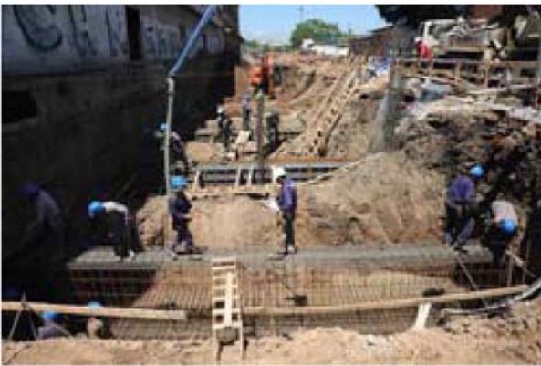
Personal afectado a tareas de excavaciones y armaduras de hierro para el Edificio Nuevo – Institutos.
