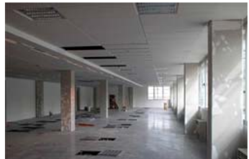
Piso técnico instalado en el segundo piso del edificio Rojo – Ministerio.
