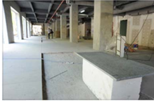
Se instalan pisos de granito, en el interior del acceso sobre la calle Paraguay.
